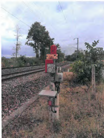
Téléphone d'alarme aux abords des voies
